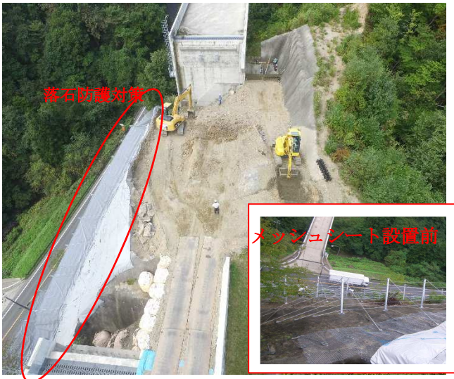
補強土壁掘削作業時の落石防護施設
